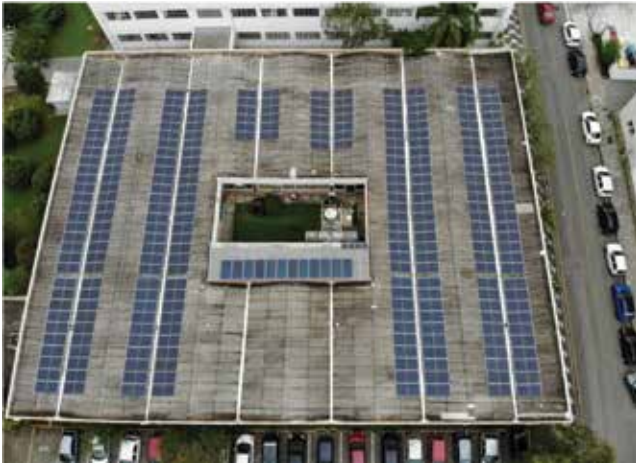
Figura 4 – Vista aérea da usina FV-DELT.
