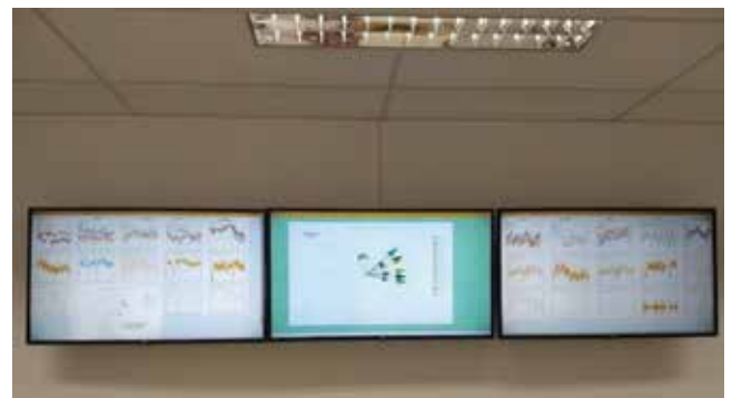
Figura 6 – Monitores da Central de Operação e Monitoramento – COM.
